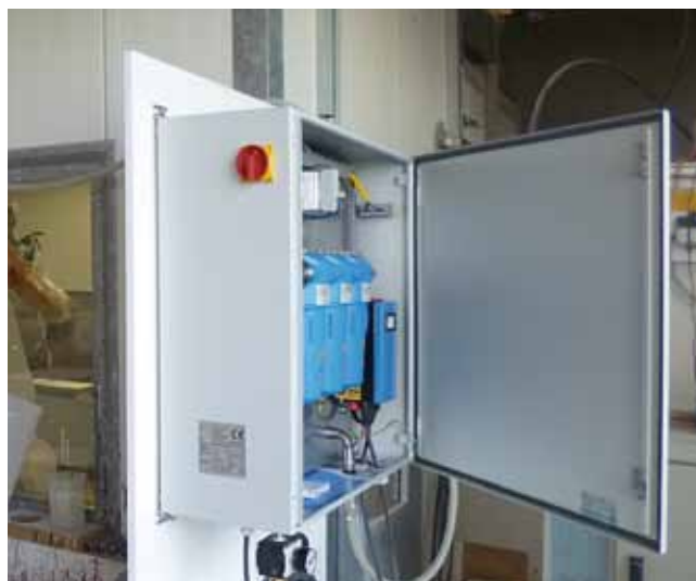
Az installáció szűrő rendszere közvetlenül a kabinra került, robbanásbiztos kivitelben
